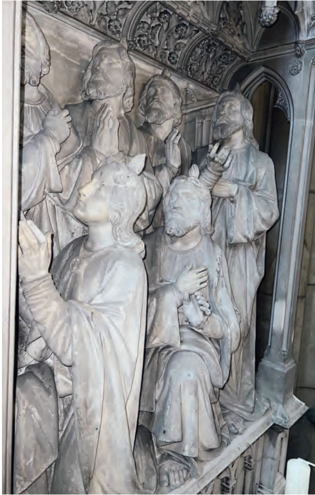
Abb. 5: Altar P „Königin der Apostel“ mit Detail des plastischen Bildwerks des Retabels –deutlich gestörter Gesamteindruck des ursprünglich „marmornen“ Charakters und Beeinträchtigung der Lesbarkeit durch gravierende Verschmutzungen, 2022
