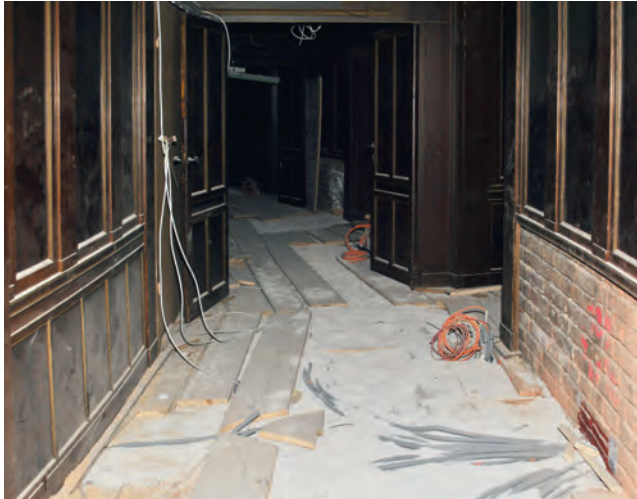
Abb. 1: Bundesversammlungssaal, Gang hinter der Galerie vor Einbau des Parkettbodens und vor Restaurierung der Wandvertäfelungen, 2021
