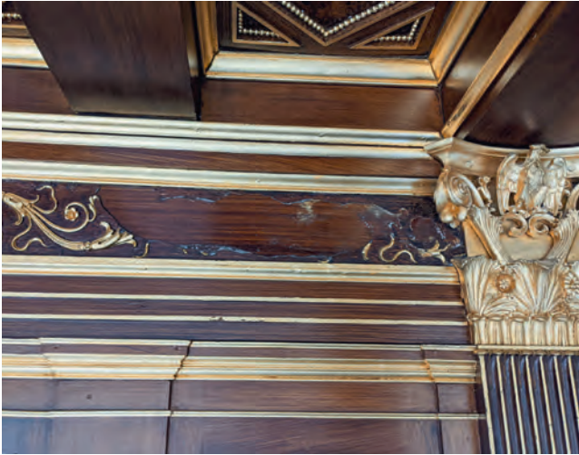
Abb. 3: Bundesversammlungssaal, Galerie, Relief Rankenfries, Detail vor der Fehlstellenergänzung mit sichtbarer Erstfassung, 2019
