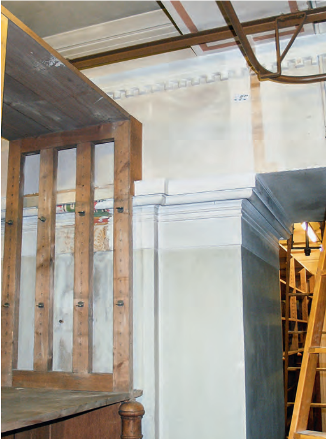
Abb. 5: Befundsituation auf Pfeiler und Gebälk, teils unverdeckt hinter dem Regalaufbau, 2006
