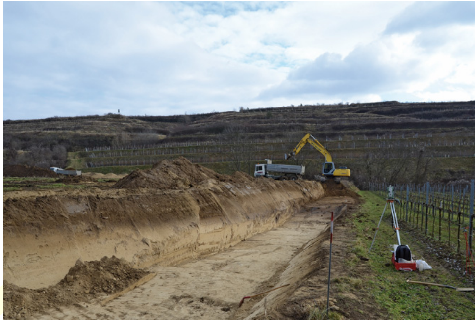
Abb. 8: Kammern (Mnr. 12213.15.01, 12213.15.02). Der bis auf die Oberkante der paläolithischen Kulturschicht abgebaggerte Bereich des neuen Güterweges.
