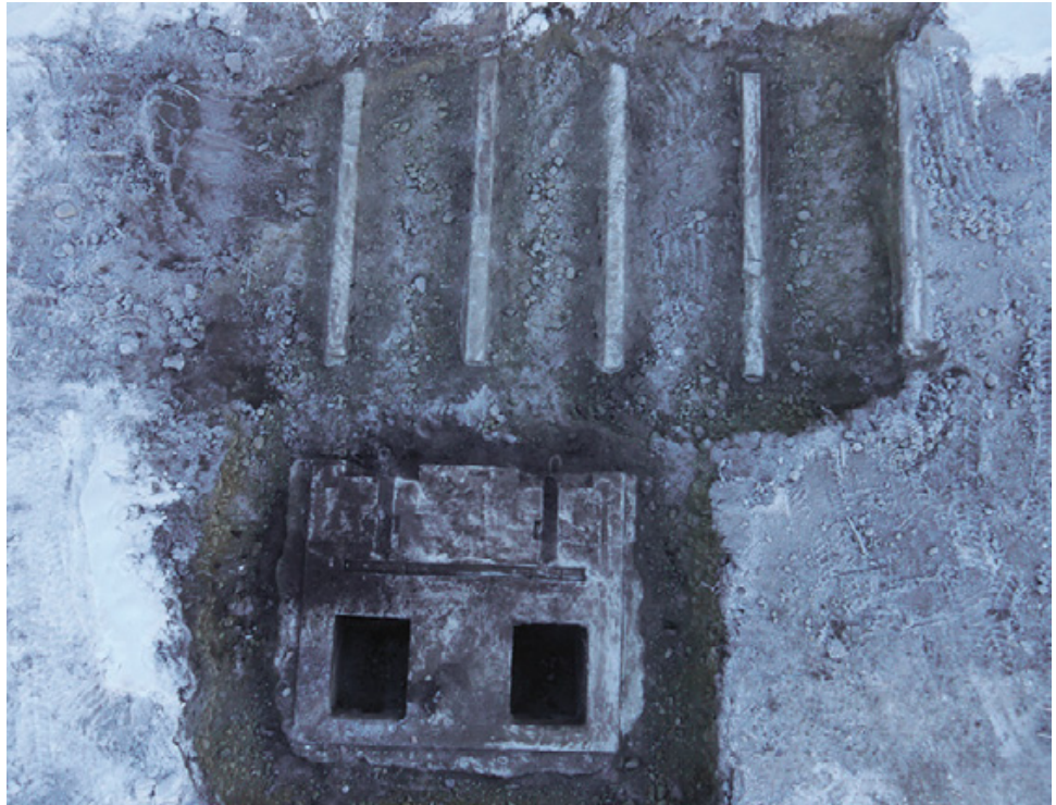
Abb. 3: Haiming (Mnr. 80101.17.01). Baustelleneinrichtung Haiming. Fundamente der Seilbahn (Gebäude L) mit den Fundamenten der Lorenbahn.
