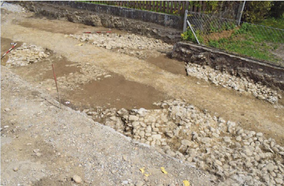
Abb. 24: St. Pantaleon (Mnr. 03121.17.01). Freigelegter Ausschnitt der Lagermauer des römischen Kastells von Albing mit Innenturm.
