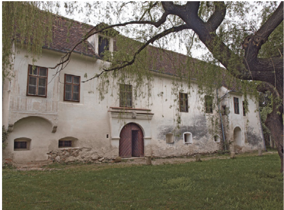
Abb. 1: Forchtenau, Unterer Edelhof. Südfassade mit dem Portal in der Mitte sowie den beiden Flacherkern rechts und links aus der Zeit um 1530/1540 (Blick Richtung Nordosten).
