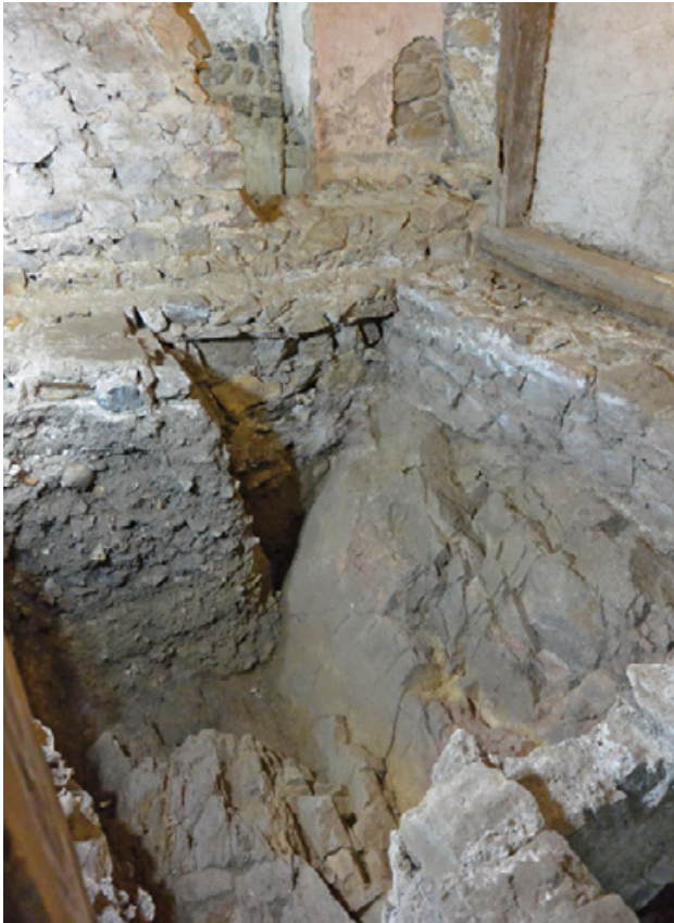
Abb. 3: Frauenburg (Mnr. 65011.17.01). Pfarrkirche hl. Jakobus der Ältere. Blick auf die Apsis, davor das ausgegrabene Areal des Seitenschiffs (Raum II).
