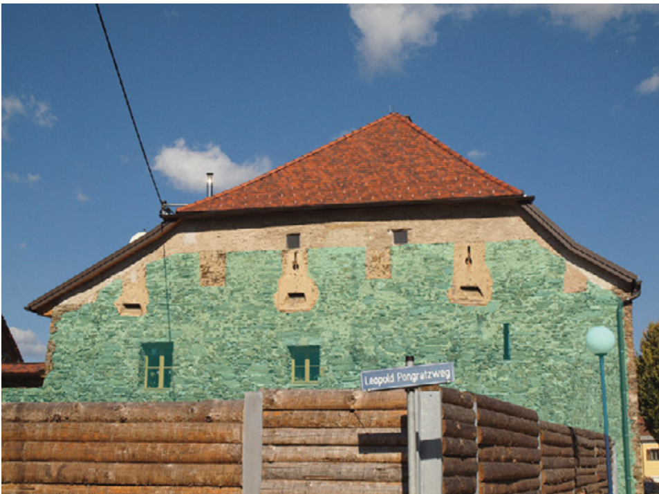
Abb. 6: St. Andrä, Stadtbefestigung. Stadtmauer westlich des ehemaligen St. Pauler Tores. Die bauzeitlichen Zinnen samt Mauerwerk der Bauphase um/nach 1339 sind farblich gekennzeichnet. Die Schlüsselloch-beziehungswise Senkscharten mit Putzrahmungen stammen aus der Zeit um 1480/1500.
