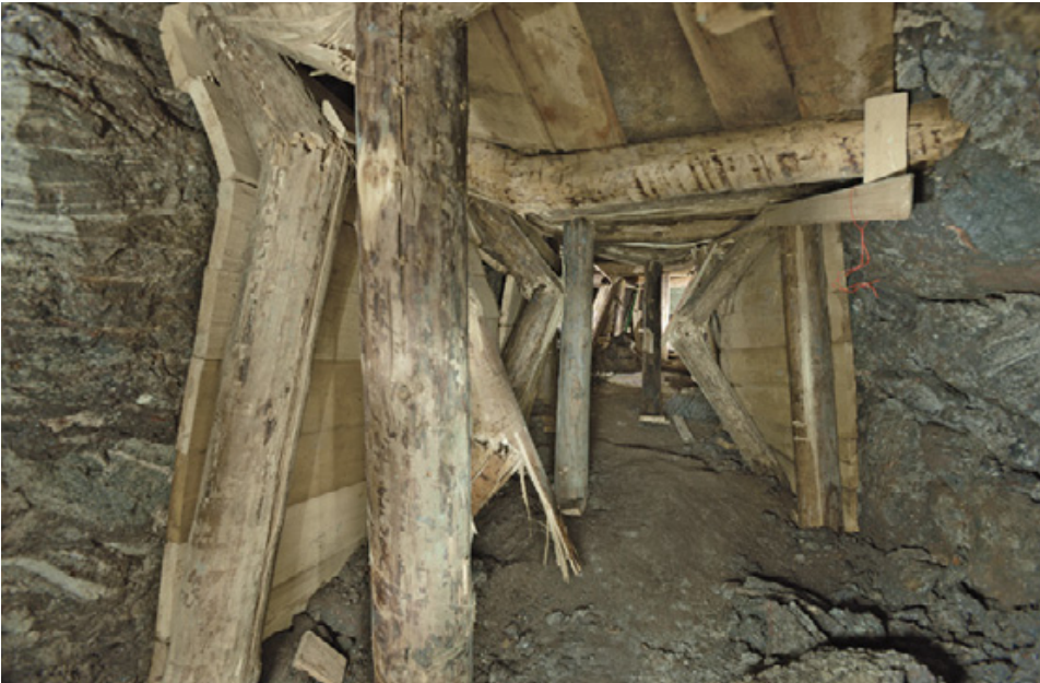
Abb. 22: Hallstatt (OÖ.). Zustand des Enderwerk-Rutschschurfes vor Beginn der Instandsetzungsmaßnahmen 2017.
