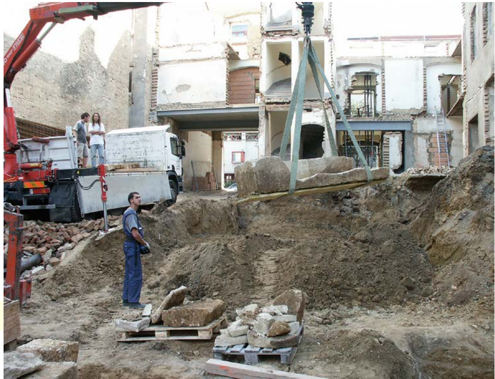
Abb. 5 Wien-Hernals, Ottakringer Straße Nr. 16. Abtransport der Römersteine mit Kran von der Baustelle.
