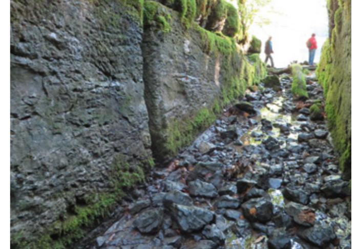
Felsausnehmungen, in denen ursprünglich die hölzernen Stauwände des Triftkanals befestigt waren © BDA, Foto: Stephan Bstielier
