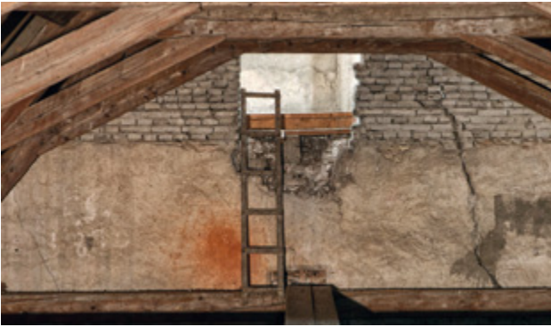
Abb. 30 Orth an der Donau, Schloss. Nordostturm. Verputzte Südfassade im Dachgeschoß des Osttrakts mit vermauertem Rechteckfenster, vermutlich um 1334.
