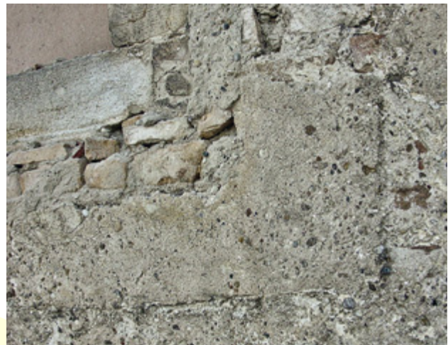
Abb. 42 Orth an der Donau, Schloss. Nordtrakt, 2. Obergeschoß. Primäre, verputzte Fensterfasche an der Nordfassade, vermutlich ab 1523 (Aufnahme 2004).
