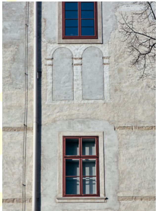
Abb. 47 Orth an der Donau, Schloss. Westtrakt. Ostfassade mit vermauertem Biforienfenster zwischen den heutigen Geschoßen sowie Fehlstelle und abgeschlagenem Kordongesims, ab 1523/1525 (Aufnahme 2011).
