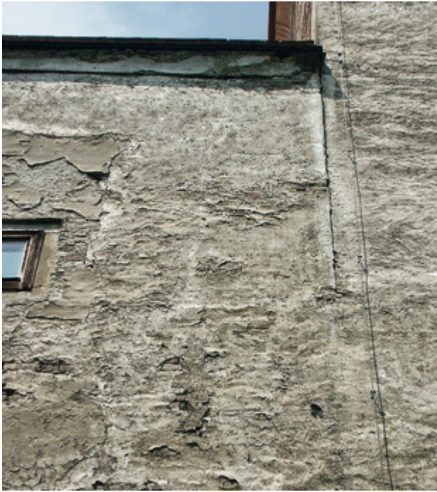
Abb. 68 Orth an der Donau, Schloss. Osttrakt. Ostfassade mit Baunaht zum Nordostturm im 2. Obergeschoß (Aufnahme 2004).
