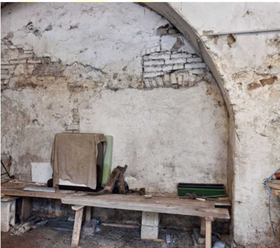
Abb. 39 Orth an der Donau, Schloss. Raum EG3. Der Bogen sitzt im Norden auf einem Pfeiler auf, dessen abgefaste Südostkante in einer Diamantierung mündet (Blick nach Westen).
