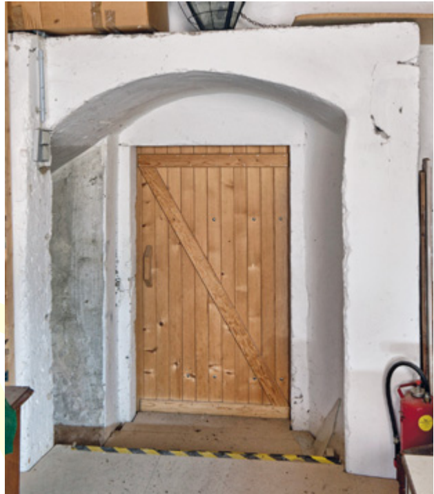
Abb. 71 Orth an der Donau, Schloss. Nordwestturm, 3. Obergeschoß (Blick nach Süden). Deutlich zu erkennen ist das obere Ende der mittelalterlichen Treppe in der Mauerstärke, darüber liegt (nicht im Bild) die ab 1534d eingezogene Balkendecke.
