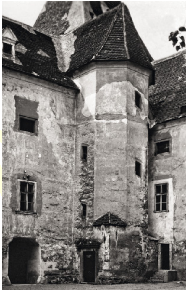
Abb. 58 Orth an der Donau, Schloss. Wendeltreppenturm. Auf Höhe der Traufe des Nordtrakts beziehungsweise der ehemaligen Traufenhöhe des Westtrakts ist deutlich eine Störzone zu erkennen (Ansichtskarte, 1965).
