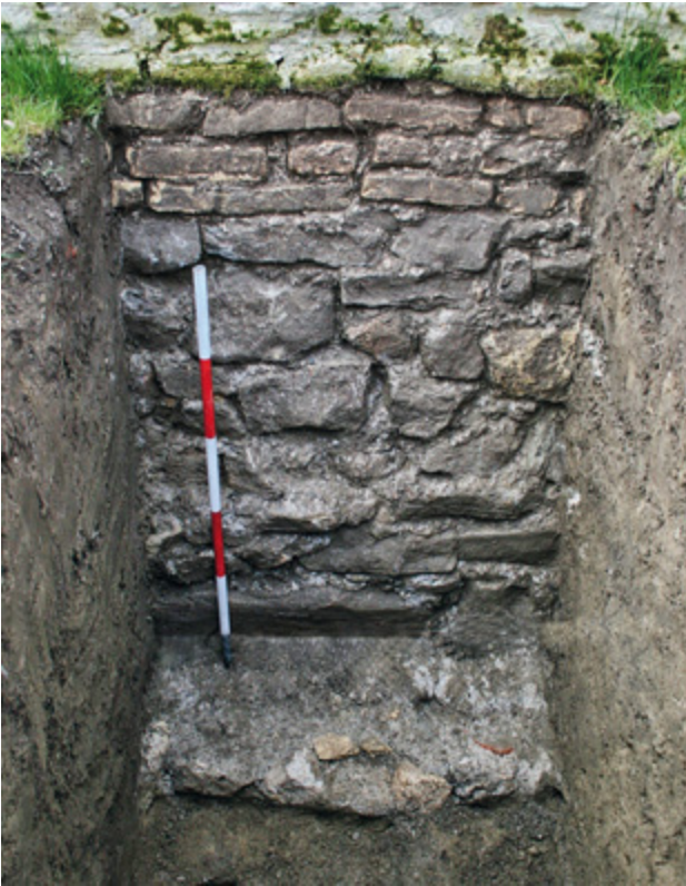
Abb. 33 Orth an der Donau, Schloss. Nordtrakt. Bruchsteinmauerwerk an der Nordfassade, vermutlich um 1444 (Aufnahme 2009).
