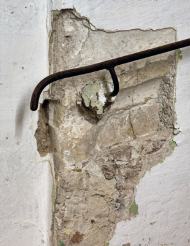
Abb. 133 Orth an der Donau, Schloss. Wendeltreppenturm. Detail des Übergangs der Griffleiste in die Nordkante der Werksteinrahmung des Portals in den Raum EG12.
