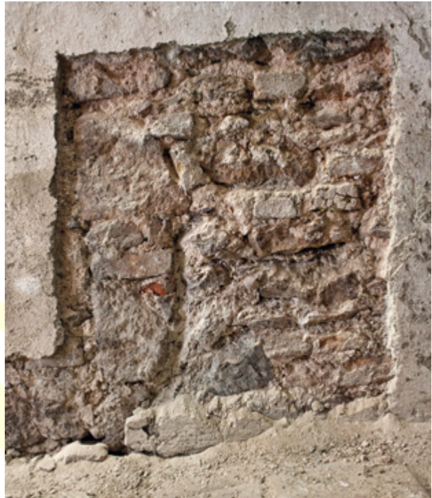
Abb. 27 Orth an der Donau, Schloss. Ostmauer des Raums EG13. Rechts Kompartimentmauerwerk mit Brandspuren, für die Errichtung eines jüngeren Durchgangs (Mitte) abgebrochen, links der Ansatz der Verfüllung des Durchgangs.
