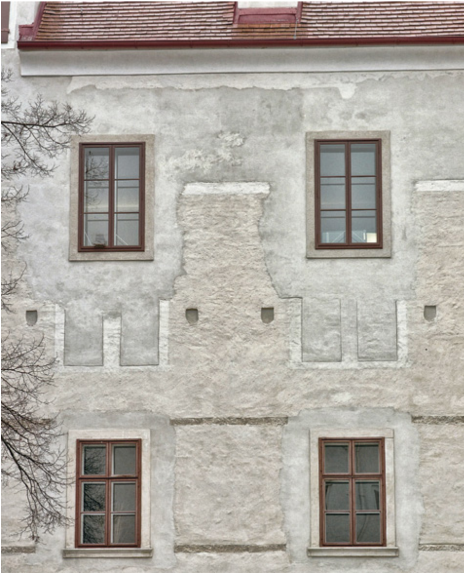
Abb. 52 Orth an der Donau, Schloss. Westtrakt. Ostfassade mit ehemaligem Traufgesims (weißer Streifen) über den Biforien, ab 1523.
