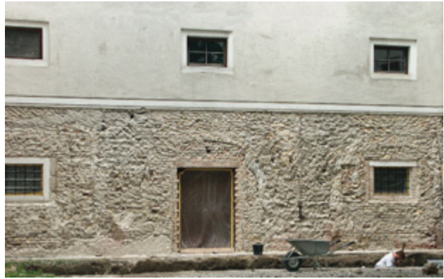
Abb. 67 Orth an der Donau, Schloss. Nordtrakt, Südfassade. Vermauerte Tür- und Fensteröffnungen im Erdgeschoß, 1530er-Jahre (Aufnahme 2004).
