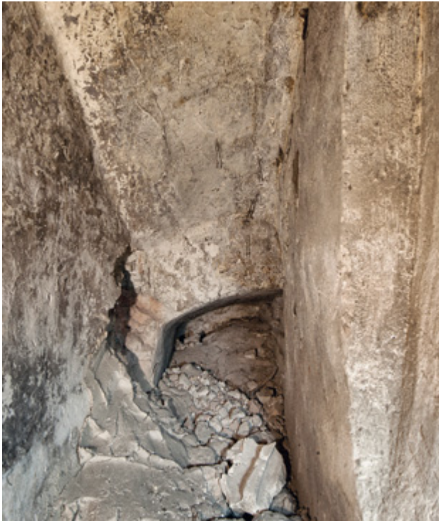
Abb. 28 Orth an der Donau, Schloss. Nordwestturm, Raum 10G10. Ehemaliger Treppenlauf in der Mauerstärke der Ostmauer.
