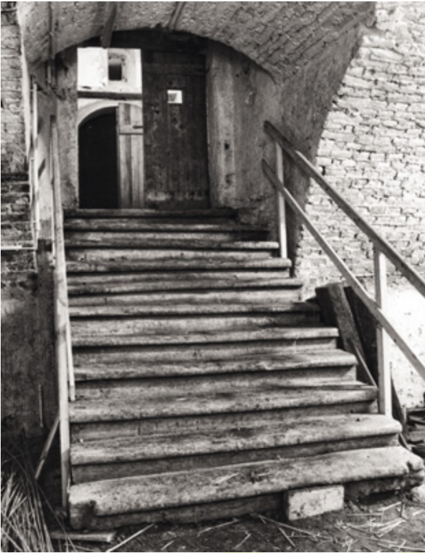
Abb. 26 Orth an der Donau, Schloss. Nordtrakt. Blocktreppe im Kellerraum EG17, um 1334 (Aufnahme 1991).
