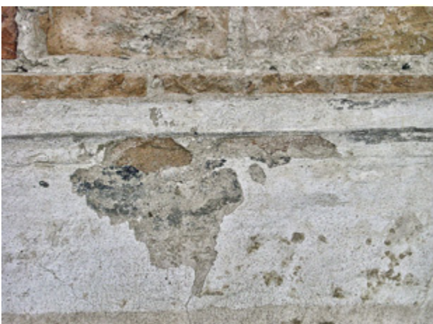
Abb. 53 Orth an der Donau, Schloss. Westtrakt, Ostfassade. Abgeschlagene Ziegel des ehemaligen Traufgesimses mit schwarzem Begleistreifen, ab 1523 (Aufnahme 2004).
