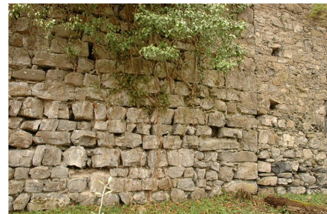
Burgruine Blumenegg, Baufuge zwischen links, ehemaligem Bergfried, und rechts, Ringmauer
