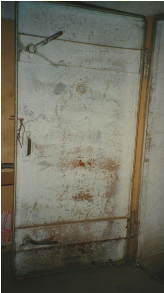
Abb. 122: Bunkertür der Wiener Firma „Viktor Otte & Co“ im Ostbahnhof-Bunker. Während der Angriffe blieben die Bunker durch druckfeste Stahltüren verschlossen.
