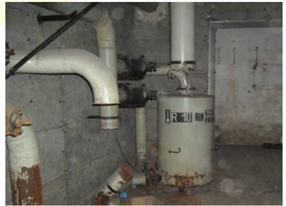
Abb. 116 (oben): Ständig sollten die Maschinen Frischluft ansaugen, die bei Normalbetrieb in die Luftschutzräume gepumpt wurde.
