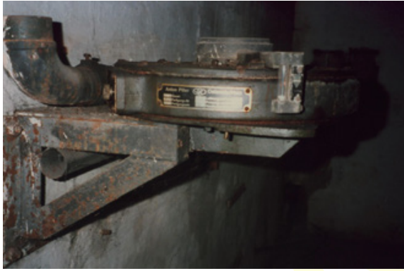
Abb. 121: Verbliebenes Relikt eines Lüfters (Fabrikation Piller) in einem Maschinenraum im Bunker-Ostbahnhof.
