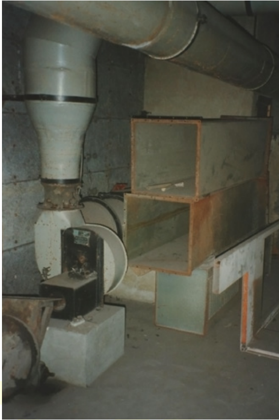
Abb. 115: Blick in den Maschinenraum des Ostbahnhof-Bunkers. Teile der Lüftungsanlage. Im Bild u. a.: Motor: „Auer Abt Raumbelüftung, Auer Luftförderer V 50000, Fabr. Nr. 258 594, Leistung: 50.000 Ltr. bei 1.430 Umdrehungen Doppelhuben p. Min, Berlin. Bei falscher Drehrichtung, doppelter Kraftbedarf, Motor gefährdet“.
