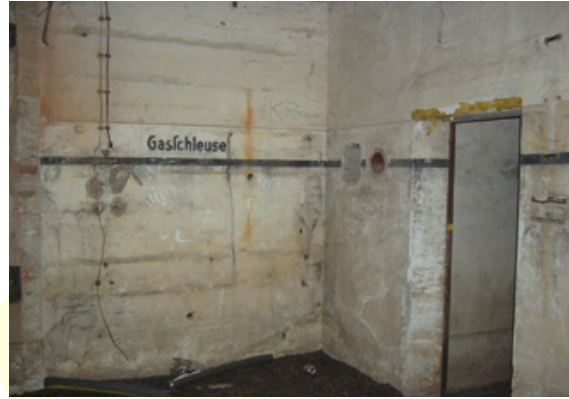
Abb. 109: Bereich der Gasschleuse im Südbahnhof-Bunker. Bevor man den Bunker betrat, musste man die Gasschleuse passieren, die hermetisch zu verschließen war, damit kein Kampfstoff in das Innere der Anlage eindringen konnte.
