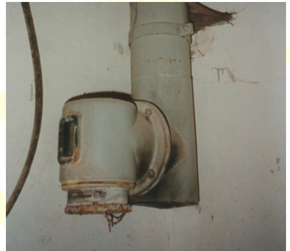
Abb. 123: Ausrangiertes Überdruckventil im Ostbahnhof-Bunker. Diese Vorrichtungen zeigten den Überdruck (gegen Gasgefahr) an. Ab einer bestimmten Menge (10-30 mbar) regulierte ein Schwimmer im Ventil bzw. eine an der Wand angebrachte Klappe den nötigen Luftdruck.
