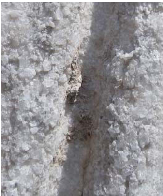
Schadensbild an Marmoroberfläche
